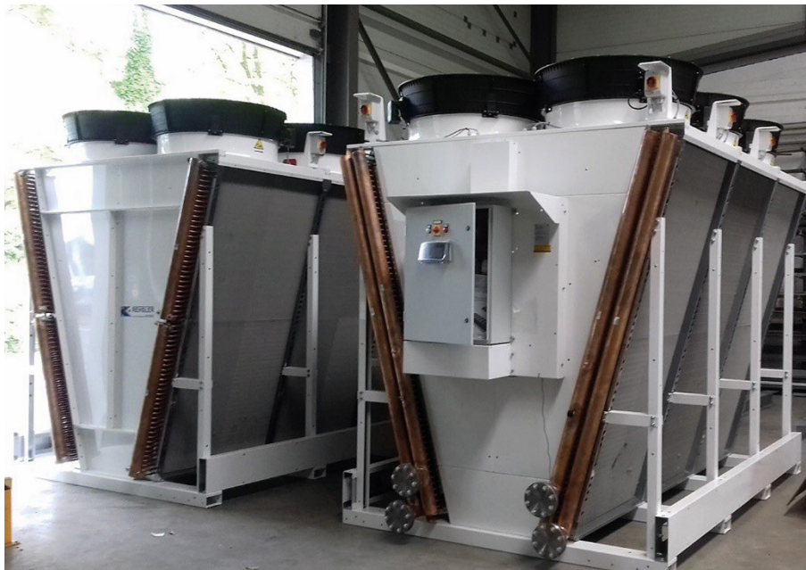
Bild 2: moderne Rückkühlanlage gemäß der Forderungen der 42. BImSchV (Quelle Foundry Service GmbH)
